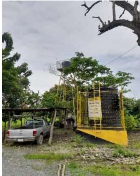
Gráfico 10: Tanque elevado y tanque implantado por la alcaldía, recinto La Fortuna
