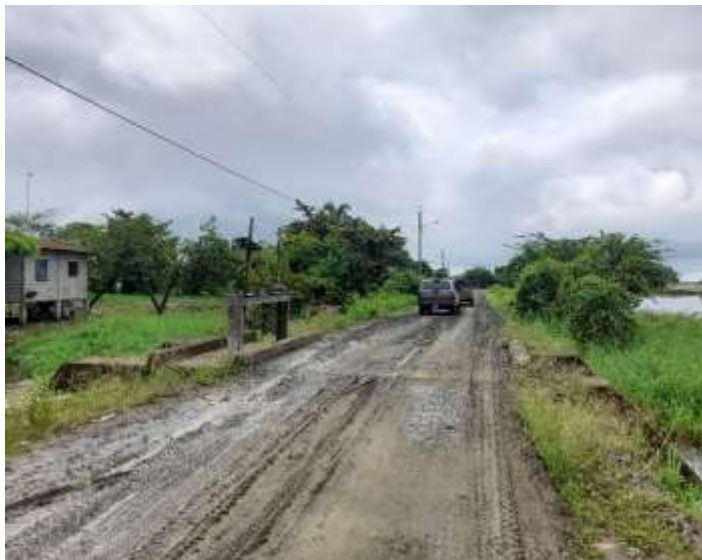
Gráfico 11: Vía en mal estado
