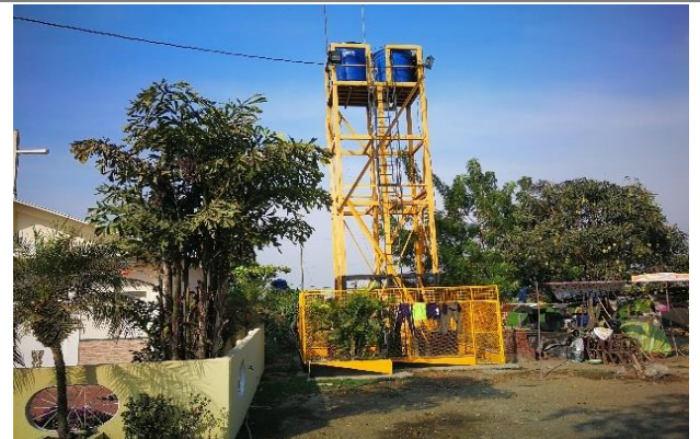
Foto 10. Sistema de agua tipo tanque elevado – Recinto Monte Alto.
