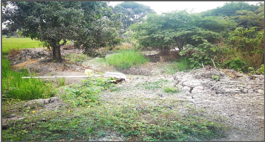
Foto 3. Resultado de la erosión del río Los Tintos en un tramo del canal ubicado en el recinto El Destino.
