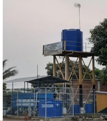
Foto 14. Sistema de agua tipo tanque elevado – Recinto Guarefirme.
