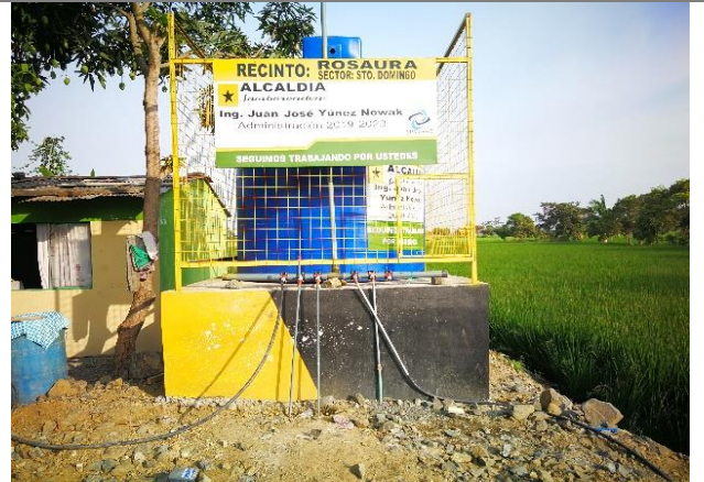
Foto 12. Sistema de agua tipo tanque-cisterna – Recinto La Rosaura.
