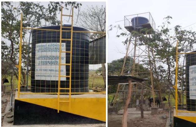
Foto 15. Sistema de agua doble: tanque-cisterna y tanque elevado – Recinto La Envidia.
